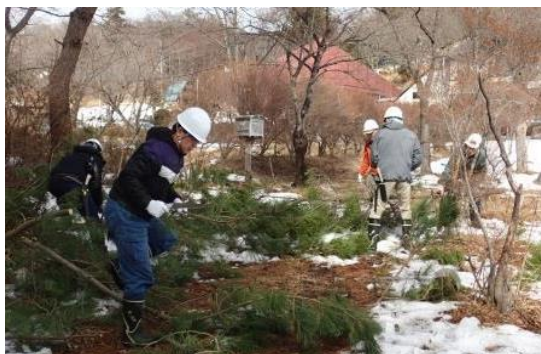
雪害で被害を受けた松の倒木の処理
